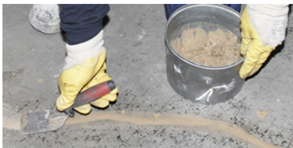
Figure 5: Égaliser la surface des fissures à l'aide d'un mortier approprié de la gamme Sikadur® / Sika Mono-Top®.
