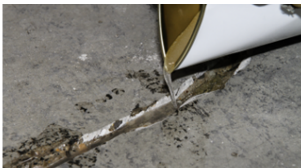
Figure 4: Verser SikalInject®-1360 directement dans les fissures qui sont coupées en forme de V. Si on n'a pas un produit de scellement prêt à l'emploi disponible sur place, préparer un mélange de SikalInject®-1360 avec sable de quartz propre et sec et remplir les rainures avec ce mortier, voir figure 5.
