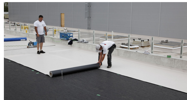
La membrane de toiture synthétique Sarnafil® est posée au-dessus du voile en fibre de verre conducteur spécial.
